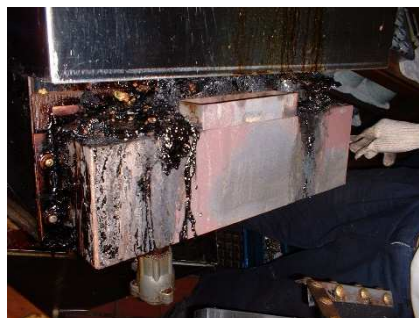
●煙突内部の汚れ
